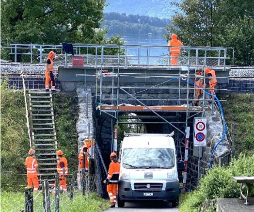
Abbildungen 11 und 12: links: Einbau der UHFB-Trogelement (mit 50 mm Blechstärke) mit UHFB-Vergießen der Querfugen; rechts: fertig eingebaute, bereits eingeschotterte UHFB-Trog (Fotos: E. Brühwiler 16.07.2024).
